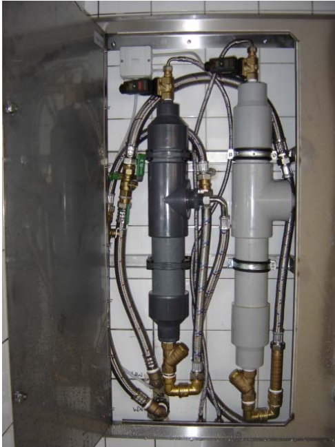
Filtri di gruppo decentrali serrabili in un armadio in acciaio inox
